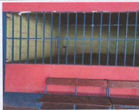
Foto 4: Se necesita sustitución de repello dañado en paredes interiores y exteriores.
