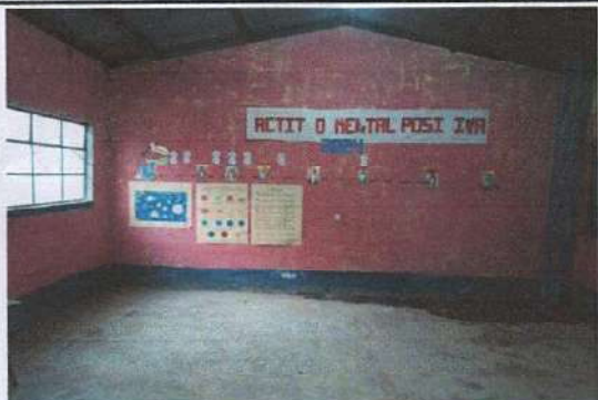
Foto 3: Se requiere sustituir el repello dañado en paredes interiores y exteriores, ya que se está cayendo por pedazos.
