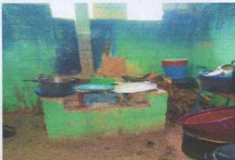
Foto 1: Se necesita sustituir estufa rural completa, porque se encuentra deteriorada y sustituir la chimenea debido a que está rota y se ahuman las paredes.
