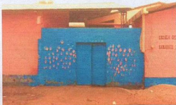
Foto 1: Se requiere sustituir el portón debido a que se encuentra deteriorado y oxidado.
