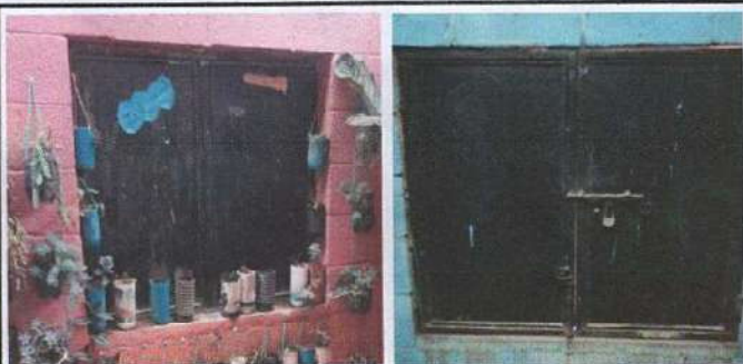
Foto 3: Se necesita sustituir ventanas de la dirección que están dobladas y no sirven lo las visagras y el pasador.
