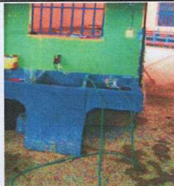
Foto 2: Se necesita sustituir el repello de la pared de la cocina ya que se encuentra deteriorado.
